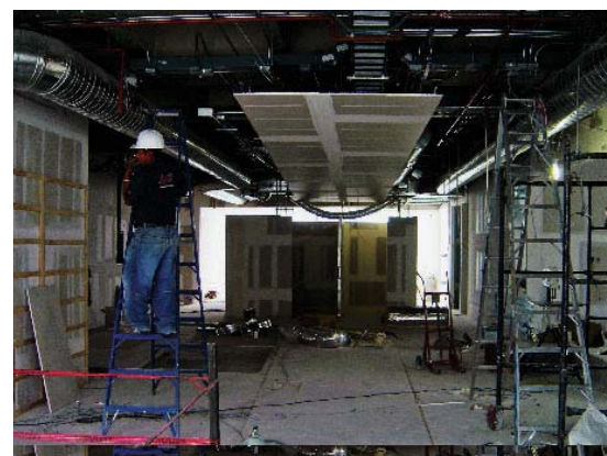
Cada bayoneta y conexión a la vista fueron ejecutados conforme a planos.
